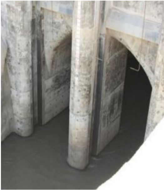
Ilustración 2.11: Fotografía de estructura para el cierre de compuertas en obra de toma. Fuente original: imagen capturada de internet
