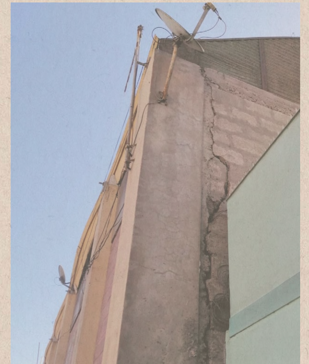
Daño en la estructura de albañilería. Archivo personal
