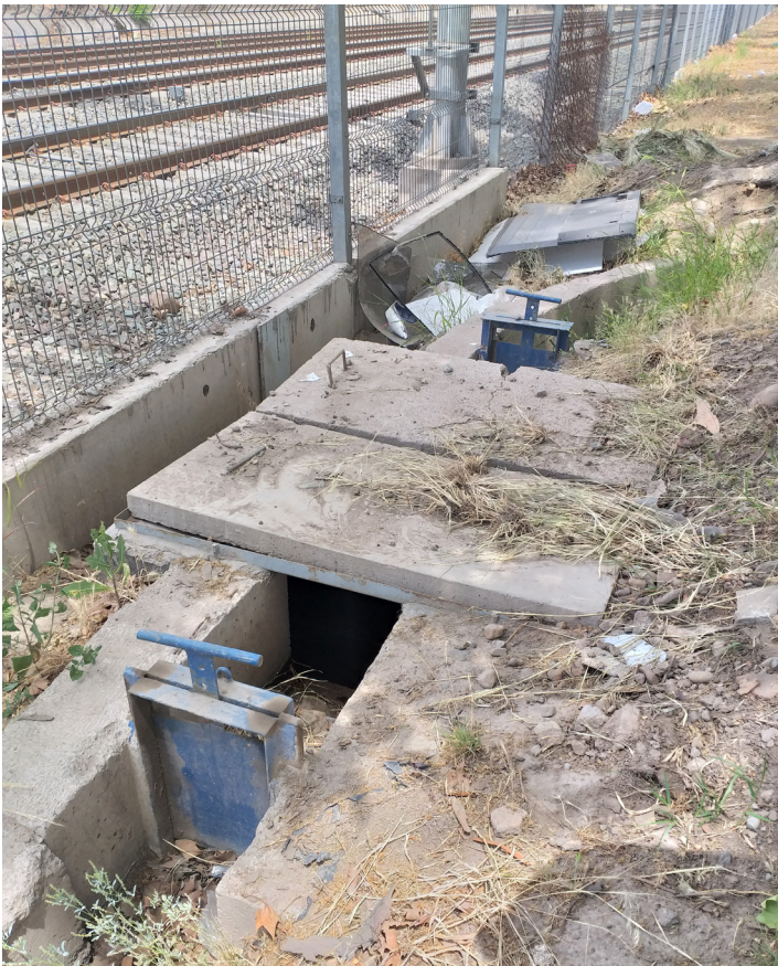
Acequia y compuerta Fuente: Elaboración propia
