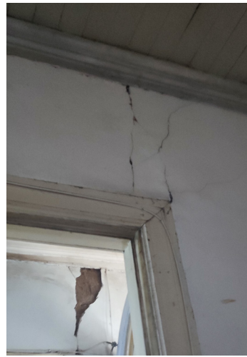
Registro fotográfico de daños
