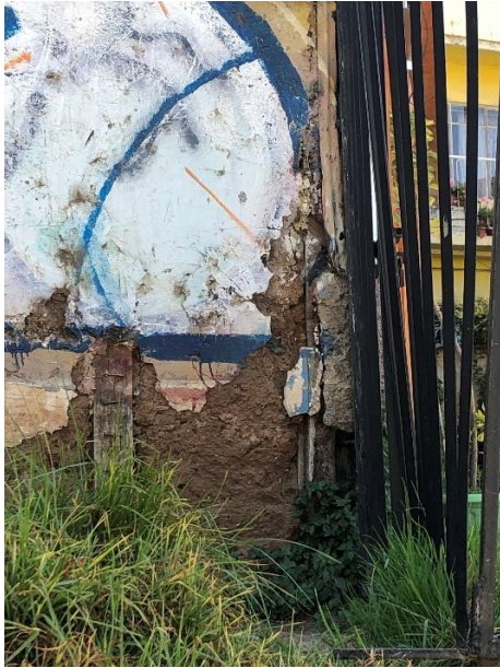
Figura 31. Deterioro de muro exterior de adobe por la humedad y aparición de vegetación correspondiente a la tipología A. Elaboración propia
