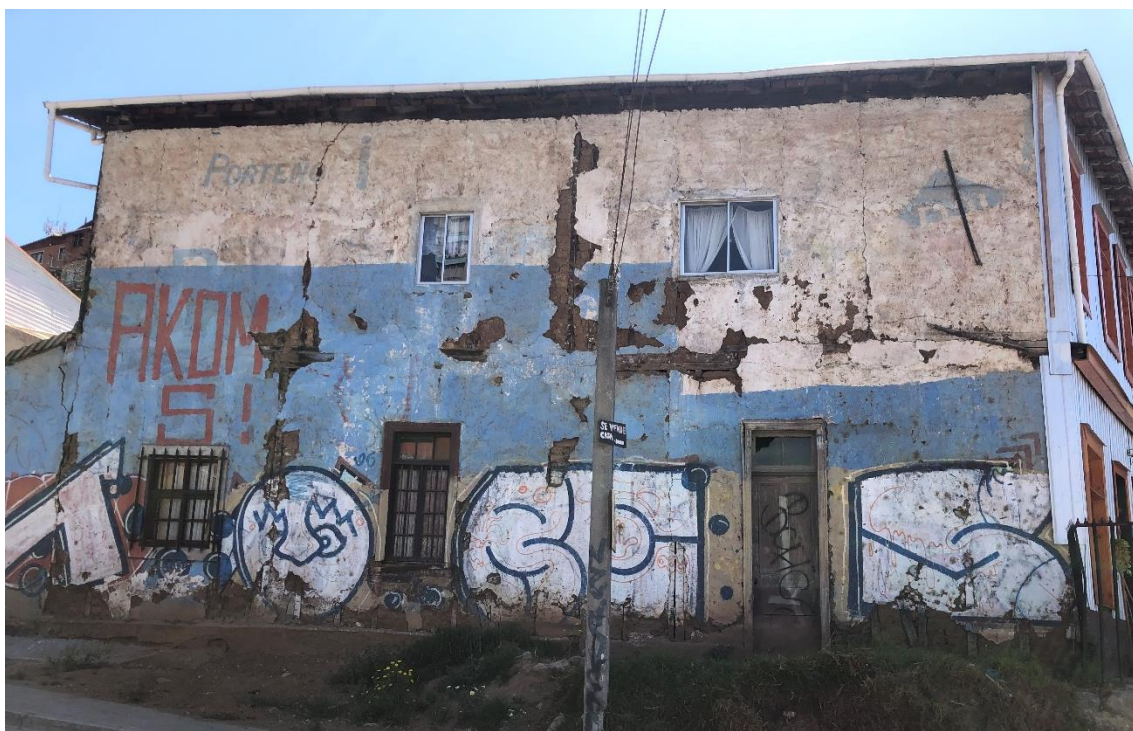
Figura 20. Deterioro y daños en fachada lateral de adobillo. Vivienda en avenida Alemania, tramo cerro Yungay perteneciente al caso de estudio. Elaboración propia.
