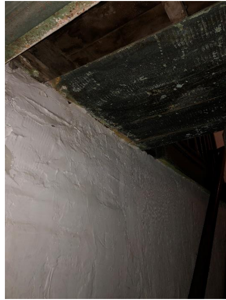
Figura 32. Deterioro de la madera del sistema constructivo en el segundo nivel inserto en la tipología A. Elaboración propia.
