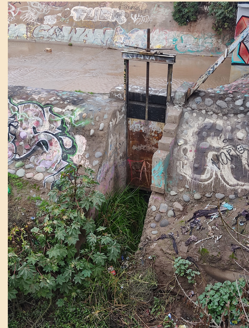
F. 20. Registro fotográfico - consecuencias de las problemáticas Elaboración propia
