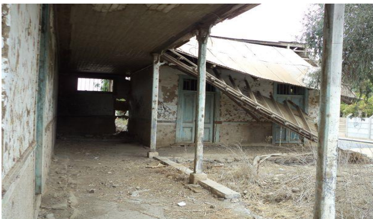
Nota. Estado de conservación de la ex estación de Pelicana. [Fotografía] autoría propia, 2022.
