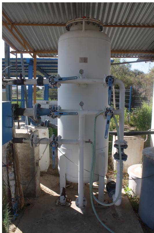
Figura 3.1: Filtro abatidor de hierro-manganeso del sistema de APR Camarico Chico.
