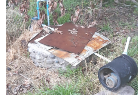
Imagen N° 20: Pozo y Bomba.
