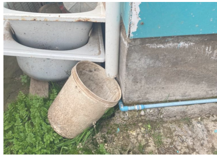
Imagen N° 42: Acumulación de Aguas Lluvia.
