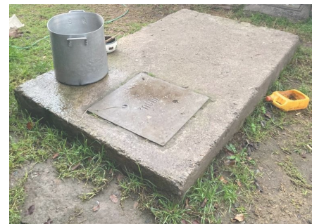
Imagen N° 35: Incorporación de fosa séptica.
