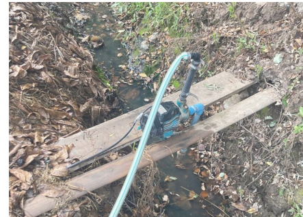
Imagen N° 39: Sistema de Extracción de agua.
