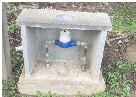
Imagen N°50: Medidor de Agua APR
