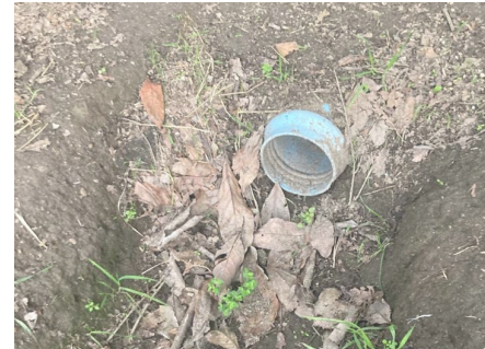
Imagen N° 19: Eliminación de Agua al Exterior.
