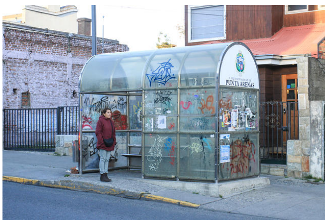
(a) Refugio deteriorado
