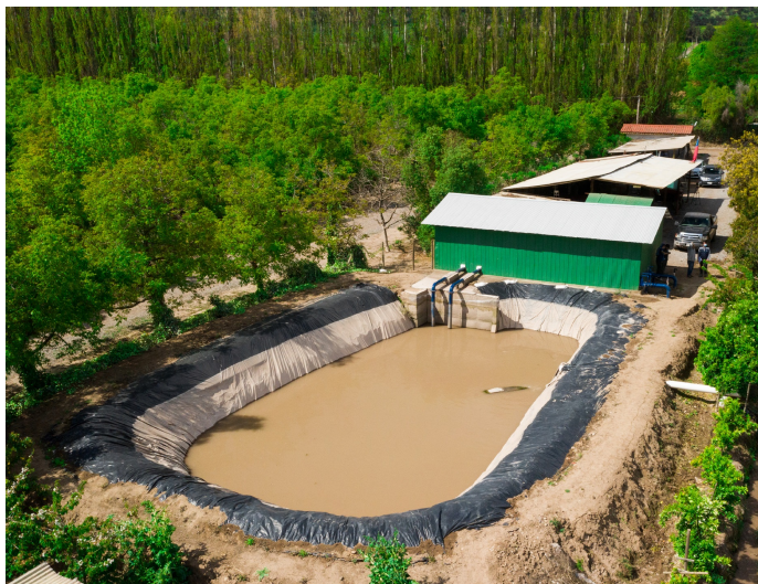
Figura 5.9: Ejemplo de sistema de bombeo para predio de 18 hectáreas. Fuente: Obtenido de [51].
