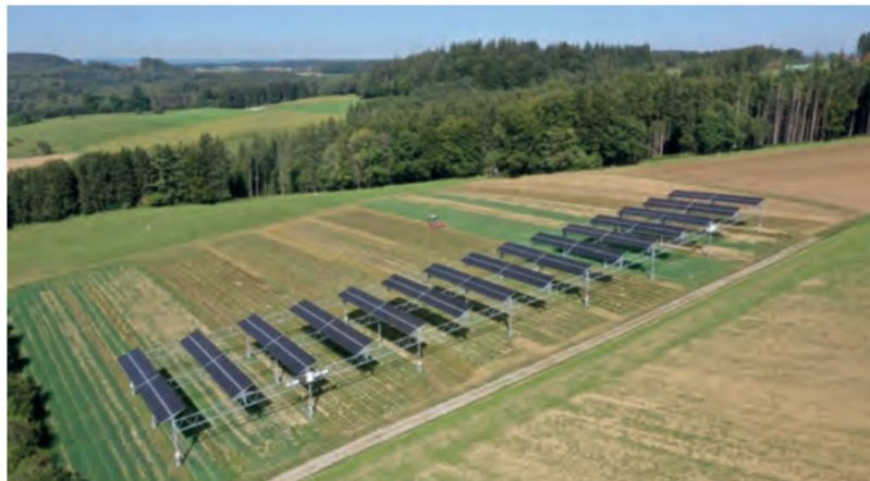
Figura 9.30: Sistema agrivoltaico en Heggelbach con una capacidad de 194 kWp que cubre un tercio de hectárea. Fuente: Obtenido de [71].
