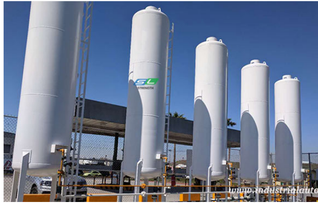
Figura 5.8: Tanques de oxígeno de SL Strenght.
