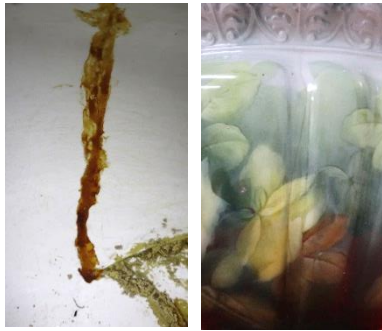
Detalle fisura interior y exterior
